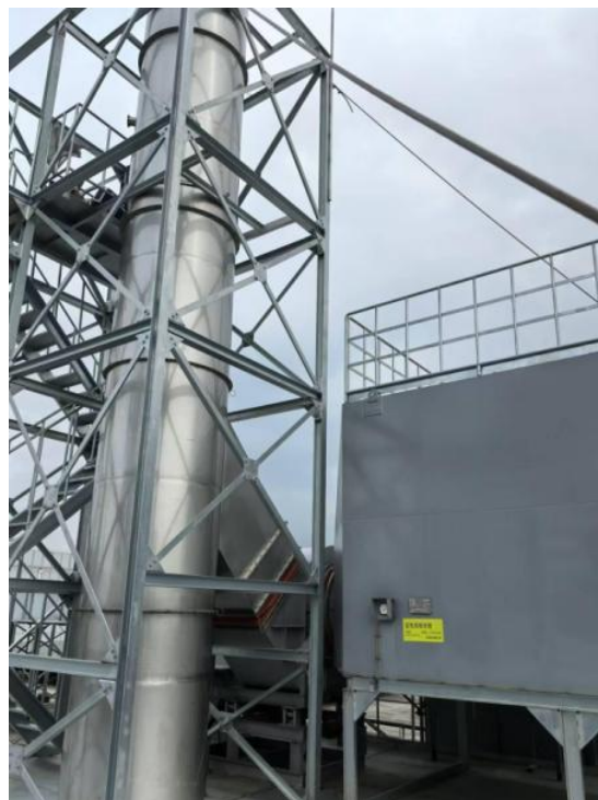
有机废气处理装置排气筒
