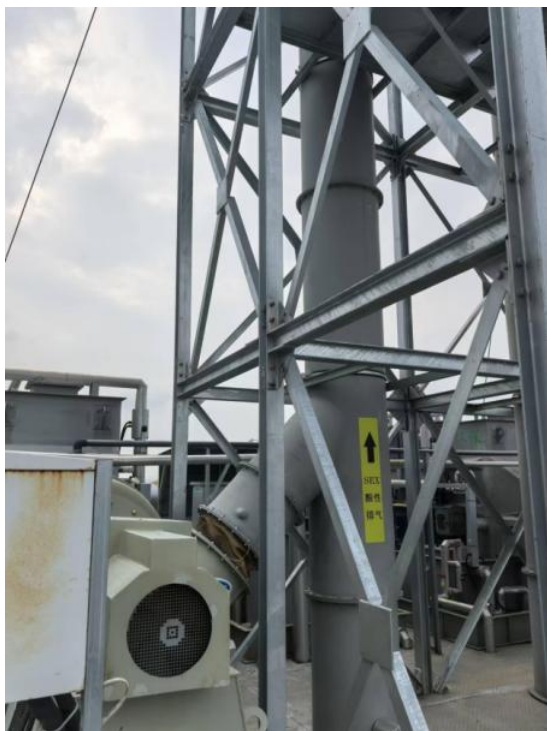
上锡酸性废气处理装置排气筒
